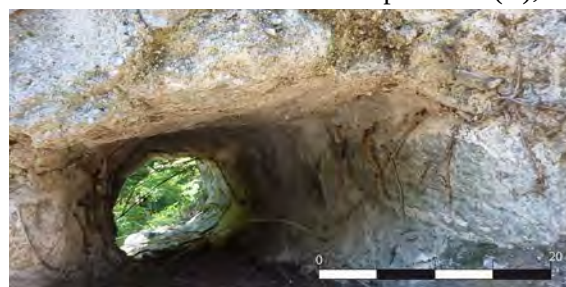
Figure 14 : Trou de poutre au-dessus de l'arche sud de la pile B.
