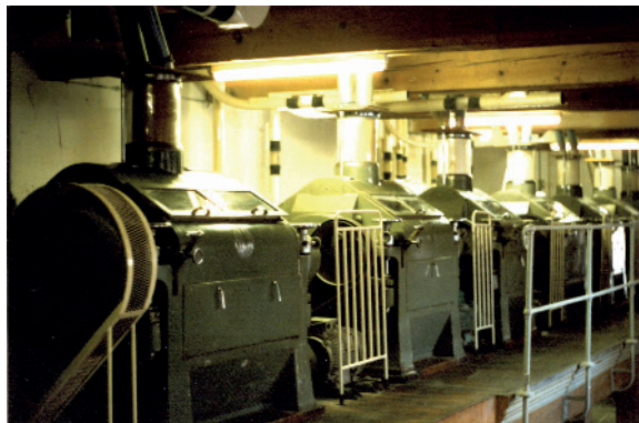
Figure 9. La salle des 7 machines à cylindres, cliché Marcel Piet.
